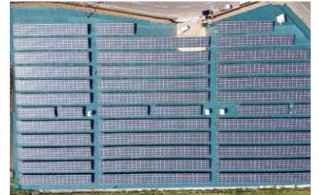
長崎県田平町太陽光発電所 1.03MW
