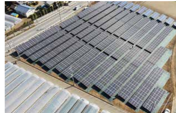
野田木間ヶ瀬太陽光発電所 642.88kW
