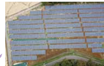
茨城県茨城町太陽光発電所 1MW
