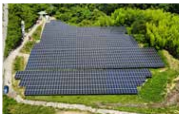
淡路岩屋発電所 1.09MW
