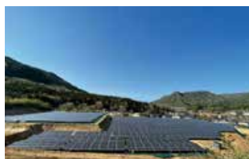
山口県下小鯖太陽光発電所 974.7kW
