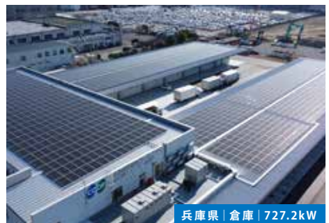
兵庫県 | 倉庫 | 727.2kW
