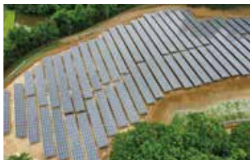
滑川町山田太陽光発電所 1.87MW
