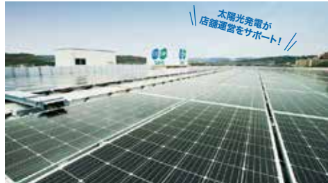
リープтонエネルギーがパネルを導入し、太陽光発電による自家消費を行っている「コープダイオ神戸西店」。屋上に出た3500㎡のパネル440枚が設置されており、自社の消費電力量は158.4kW。
