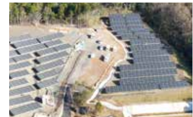
三重県志摩市築地太陽光発電所 594.32kW
