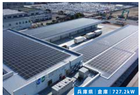
兵庫県 | 倉庫 | 727.2kW
