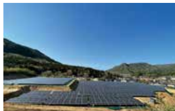
山口県下小鯖太陽光発電所 974.7kW
