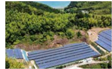
阿波福井太陽光発電所 698.88kW
