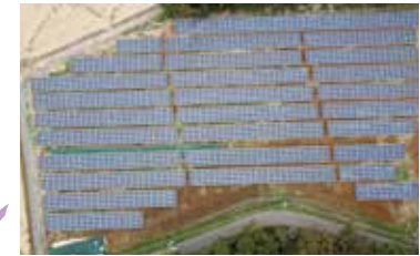
茨城県茨城町太陽光発電所 1MW
