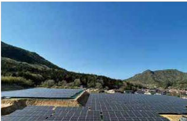
山口県下小鯖太陽光発電所 974.7kW
