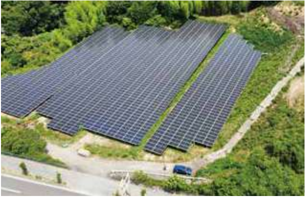
淡路市岩屋字桑ノ木谷発電所 1.09MW
