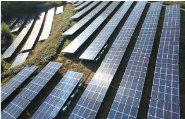
美里白石太陽光発電所 580.3kW
