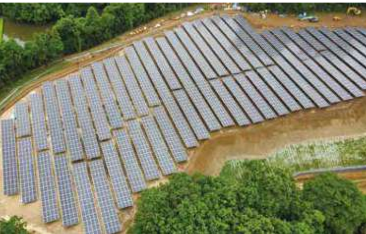
滑川町山田太陽光発電所 1.87MW
