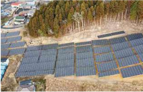
LP宮城県石巻太陽光発電所 1.35MW
