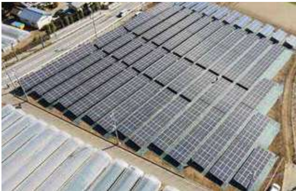
野田木間ヶ瀬太陽光発電所 642.8kW
