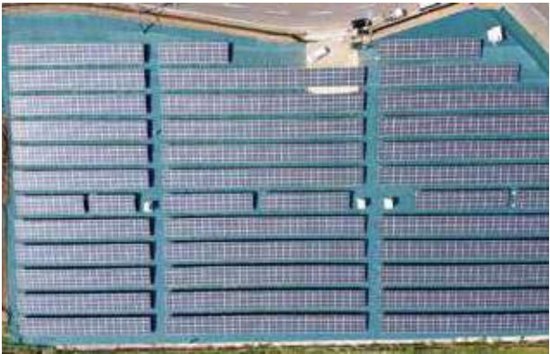
長崎県田平町太陽光発電所 1.03MW
