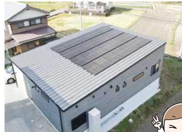
和歌山県/11.2kW 使用パネル:LP182*182-M-54-MH-410W 28枚
