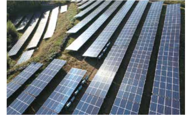
美里白石太陽光発電所 580.3kW
