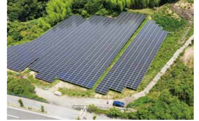
淡路市岩屋字桑ノ木谷発電所 1.09MW
