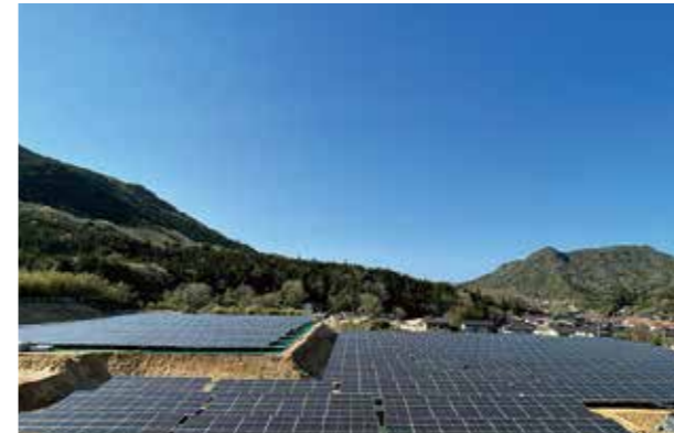
山口県下小鯖太陽光発電所 974.7kW
