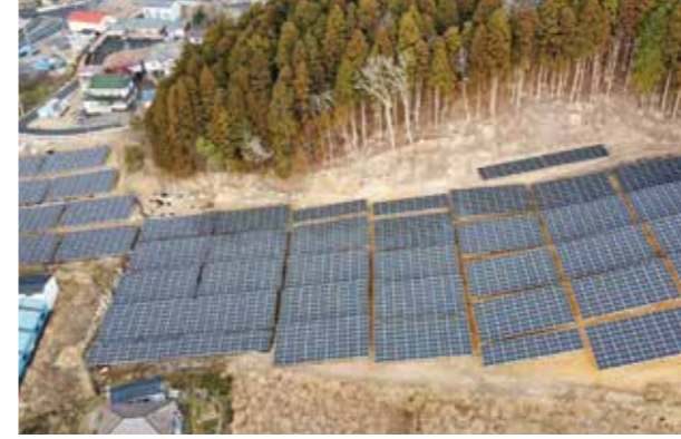
LP宮城県石巻太陽光発電所 1.35MW
