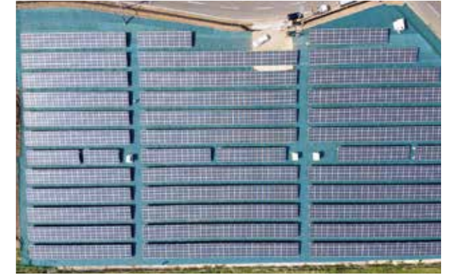
長崎県田平町太陽光発電所 1.03MW
