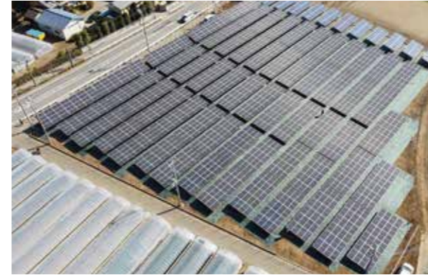
野田木間ヶ瀬太陽光発電所 642.8kW
