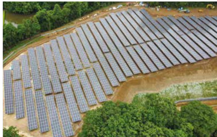
滑川町山田太陽光発電所 1.87MW
